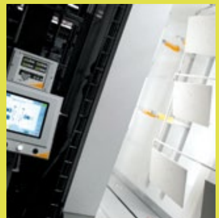
Instalación pintura en polvo ITW GEMA Powder painting ITW GEMA
