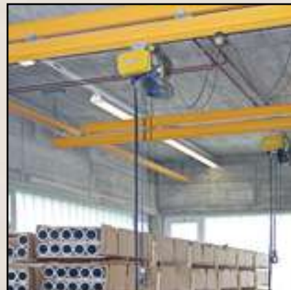
* Grúa suspendida monorraíl.
